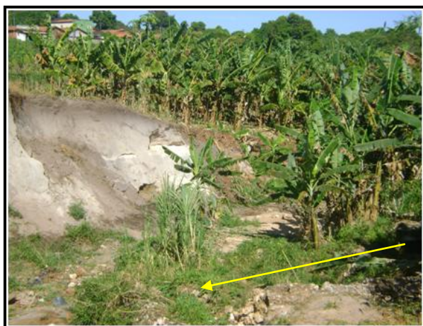
Figura 3 – Deslizamento de Depósito Tecnogênico Fluvial no Córrego Cimba. Foto: Machado, C. A. (2010)
